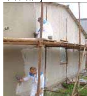
Po vložení síťoviny a osazení rohových profilů v jednom kroku proveďte vyrovnávací vrstvu ze stěrkové hmoty po celé ploše omítky
